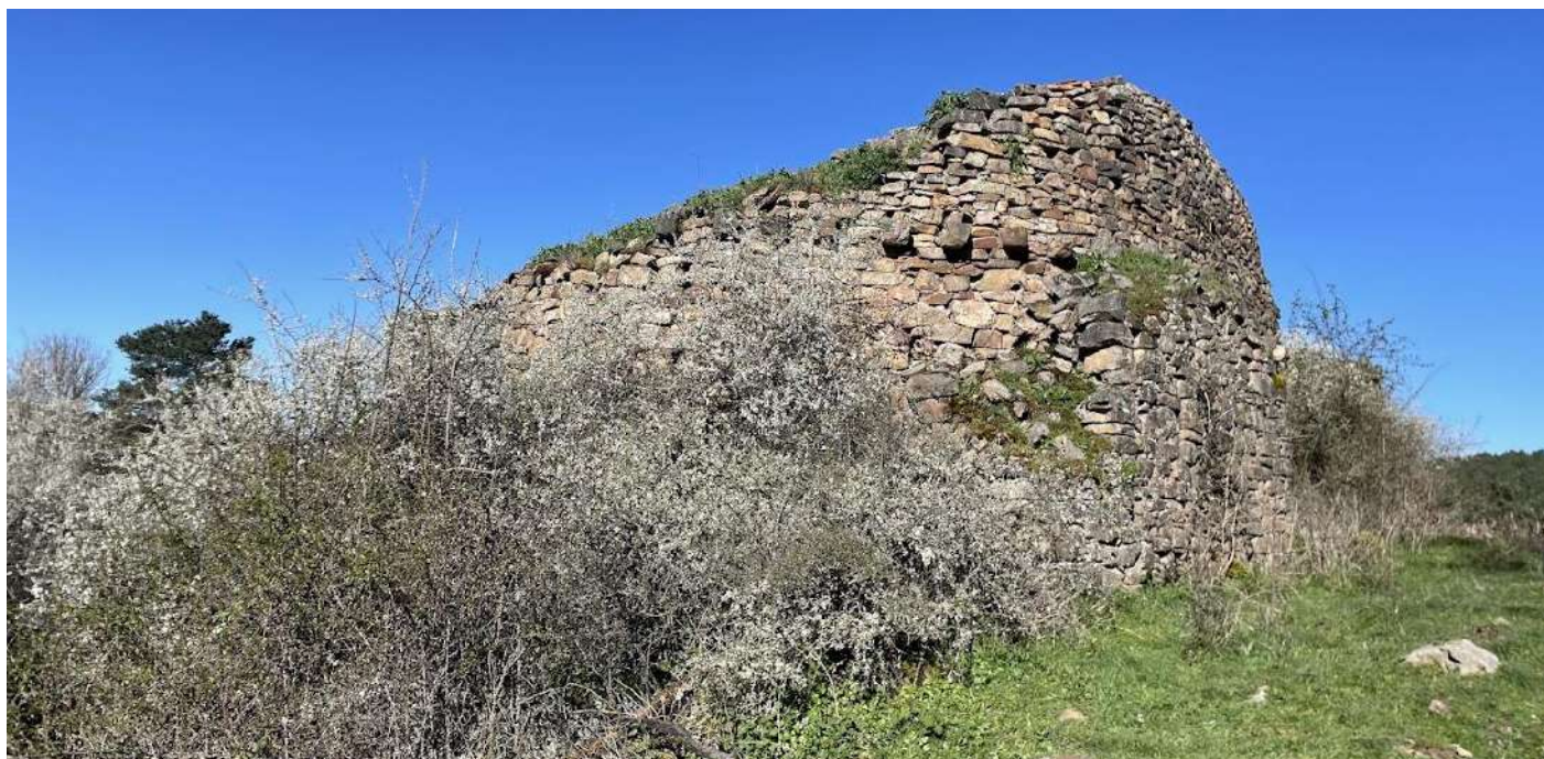
Ruinas del ábside de la antigua ermita de la Virgen del Monte, donde el paso del tiempo deja su huella entre piedras milenarias y la vegetación que lentamente reclama el lugar.
