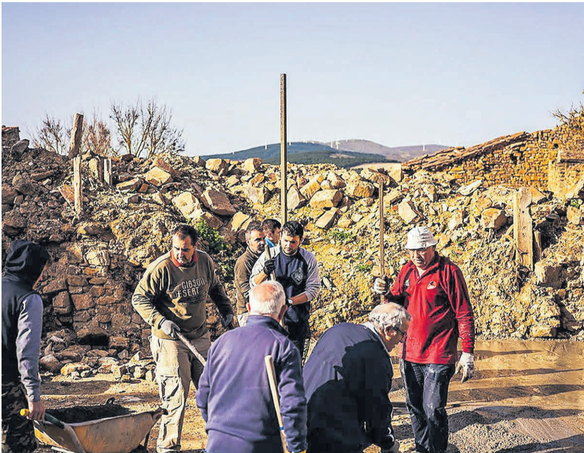
Trabajos de la hacendera para crear el centro de coworking en Sarnago el pasado 15 de abril. / CEDIDA POR MARCOS CARRASCOSA
